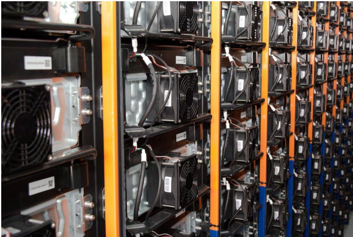
Bild 4: Detailansicht der Batterie-Einschübe
