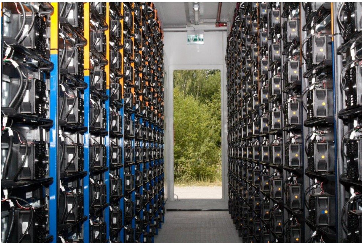
Bild 3: Batteriecontainer von innen
