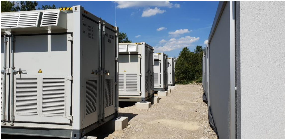
Bild 2: Batteriecontainer mit integrierten Wechselrichtern
