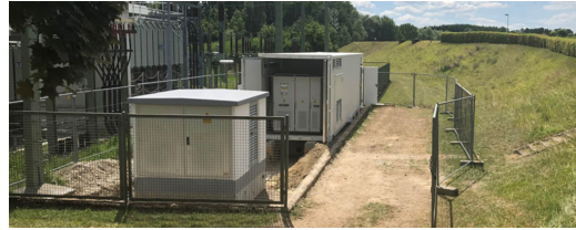
Zusammen mit dem benachbarten Wasserkraftwerk liefert der Speichercontainer Primärregelleistung. Das Hirn der Anlage ist ein selbst entwickeltes Energiemanagementsystem.
