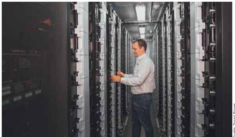
② Li-Ionen-Batterien im Container, ferner im Bild M. Eng. Ulrich Bürger, Technischer Leiter von Smart Power
